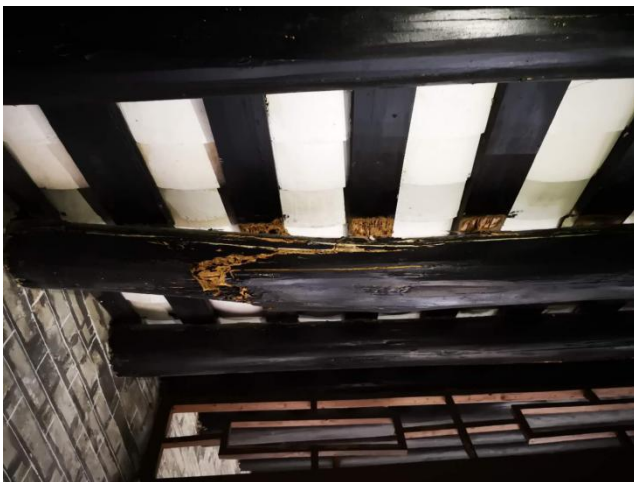
因白蚁侵蚀断裂的横梁
